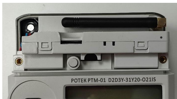
б) Модуль, установленный в ПУ
